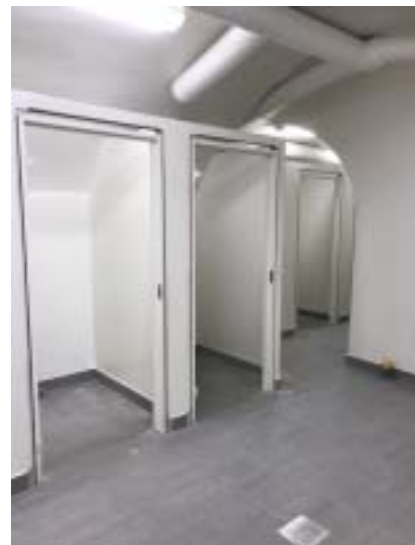
Nya toaletter och duschar i linje I och IX. Foto Lennart Larsson
